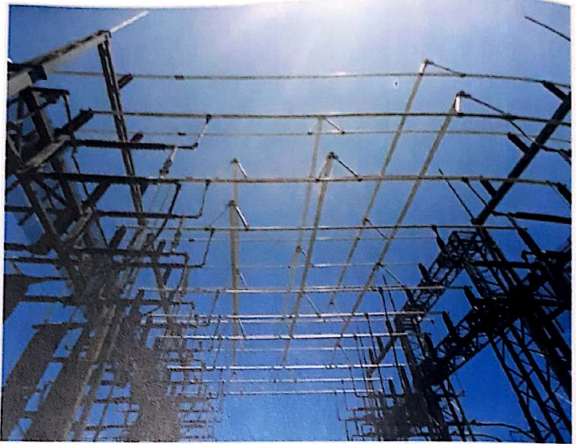
Figura A-7: Juego de Barras AT 138 kV (Maniobra manual y SCADA) [30]
