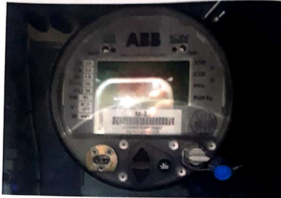
Medidor de Energía LM138 kV
