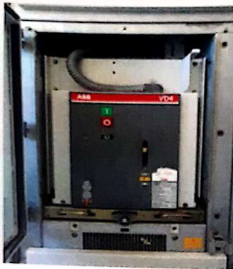
Disyuntores de Circuitos MT
