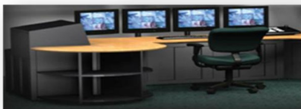
Sistema de Control de Accesos
