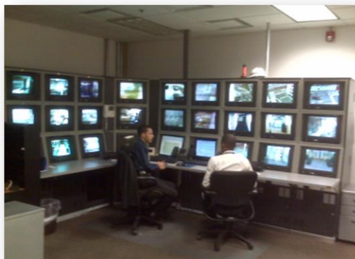
Monitores Sistema Visual Remoto
