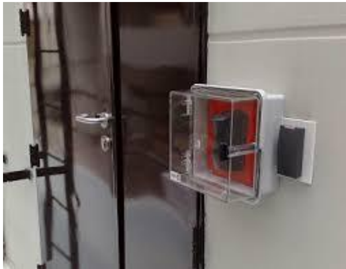
Figura 3.1. Alarma de seguridad y punto de acceso
