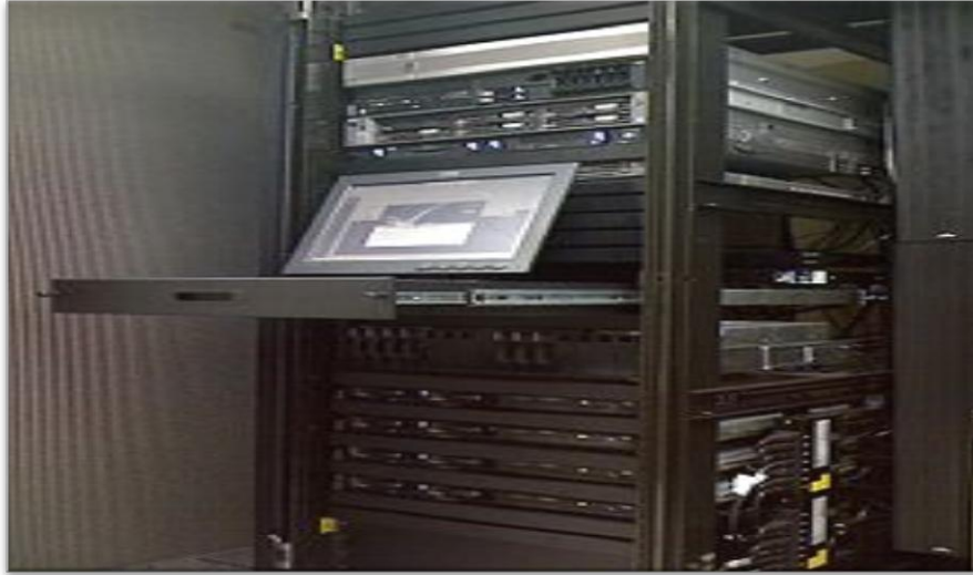
Figura 2.4. Rack de servidores tipo Blade
