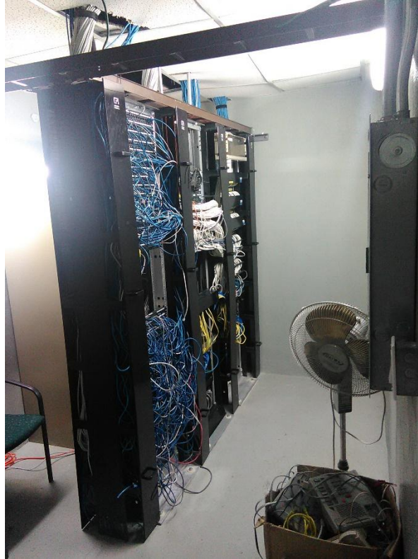
Figura 4.5. Equipos de red y telefonía en cuarto de equipos A tercer piso.
