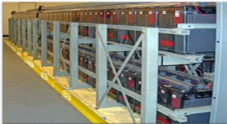
Figura 2.9. Banco de UPS
