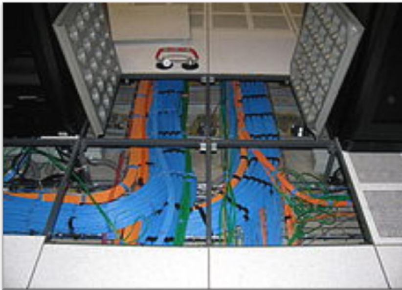
Figura 2.7. Cableado de red en subsuelo
