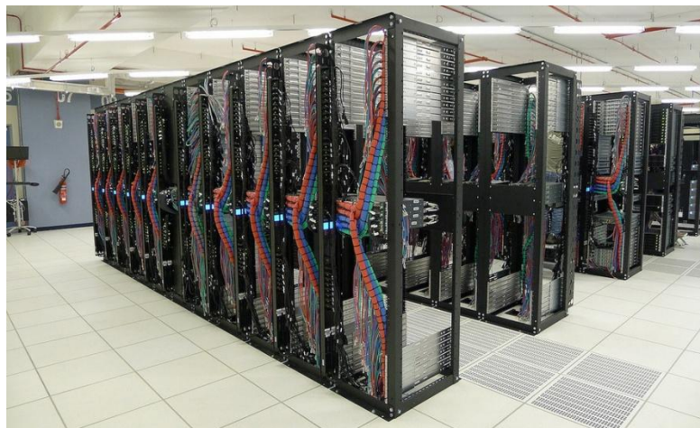
Figura 2.1. Racks Data Center
