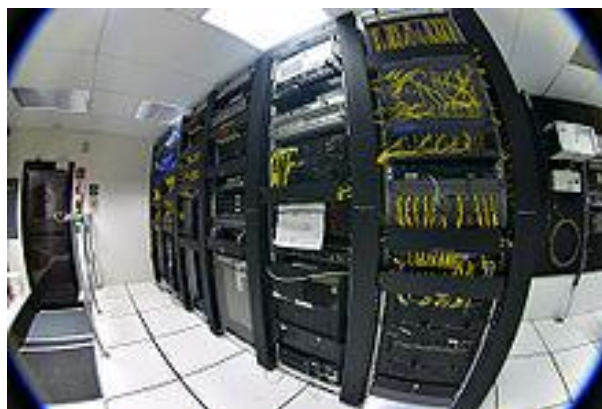
Figura 2.3. Vista de Rack con equipos de red y servidores
