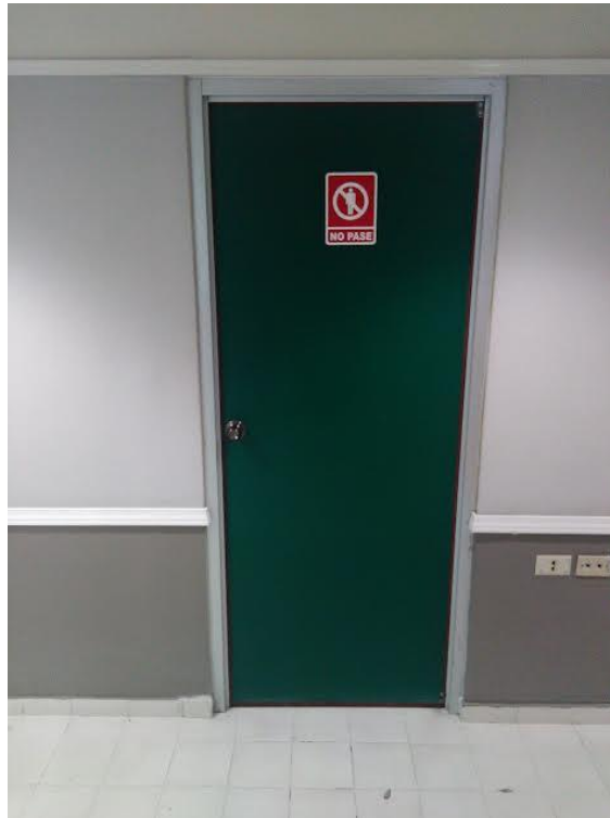
Figura 4.1. Puerta de acceso al cuarto de servidores
