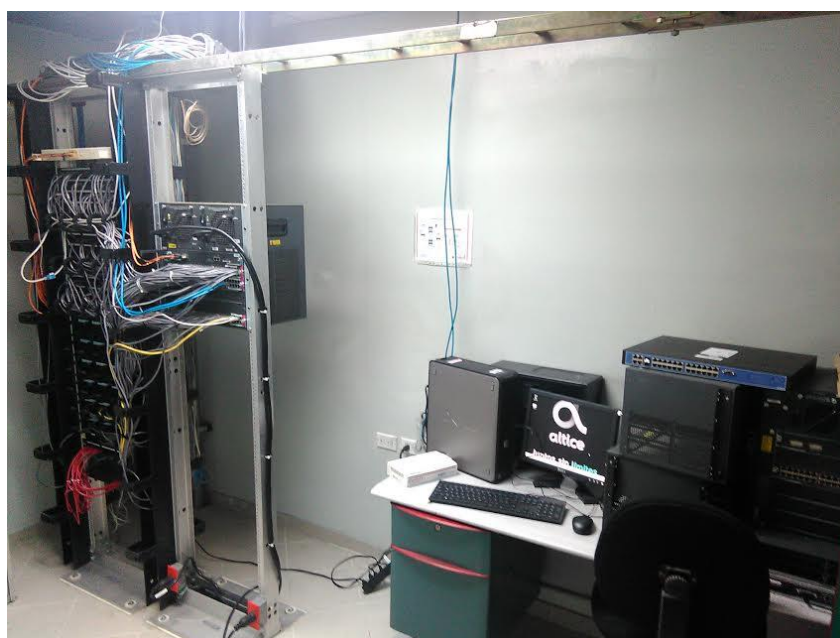
Figura 4.2. Cuarto de servidores.
