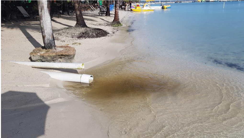
Imagen 8: Tubería restaurante Bocana (a)
