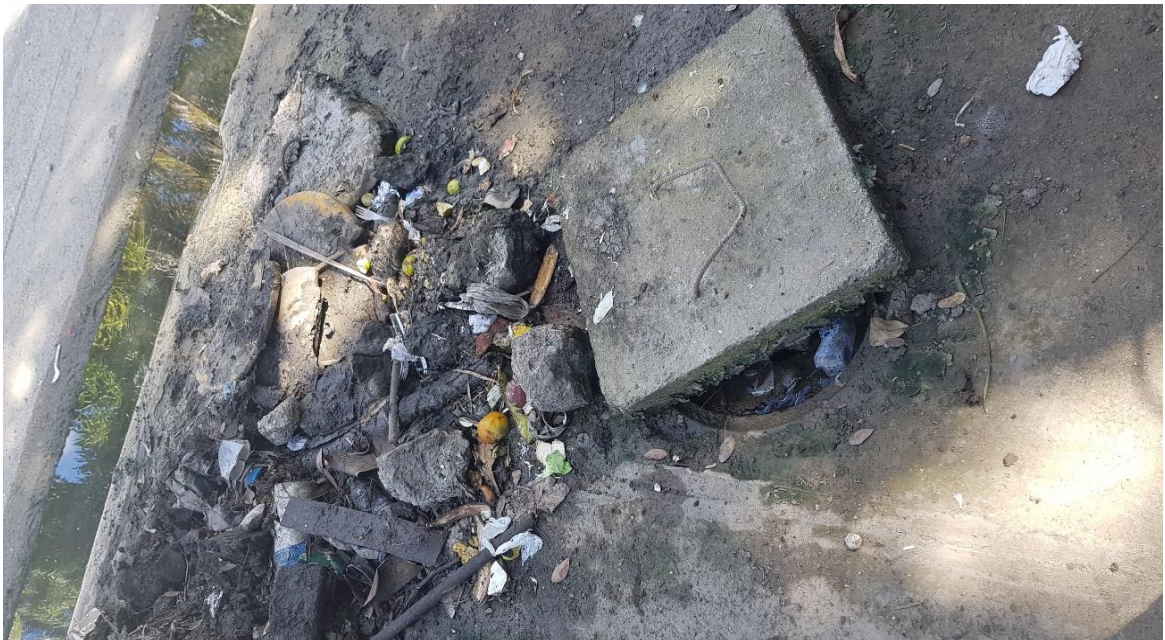
Imagen 14: Tubería obstruida por desechos solidos
