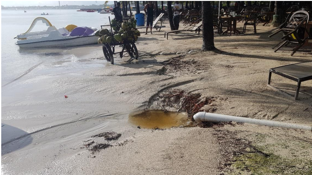
Imagen 9: Tubería restaurante Bocana (b)
