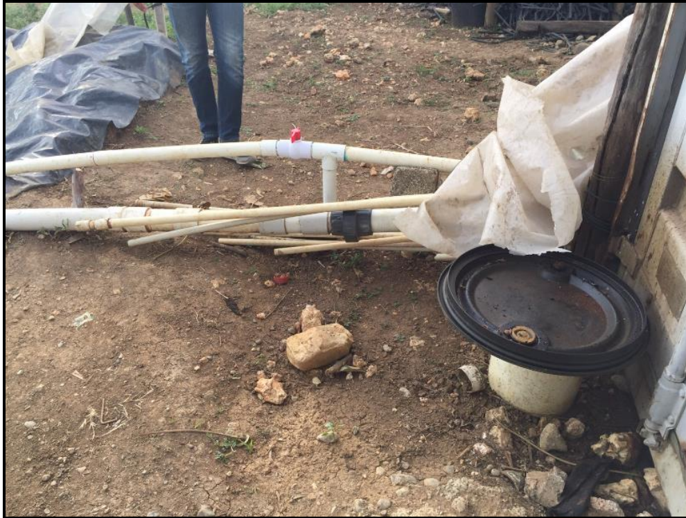
Anexo 3. Tuberías desde la bomba al invernadero
