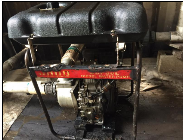
Figura 20. Bomba de agua diésel para el riego en el Invernadero de la Cruz Fuente: Invernadero de la Cruz
