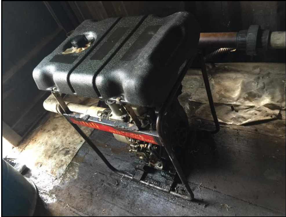
Anexo 5. Bomba de gasoil y su contaminación en su alrededor
