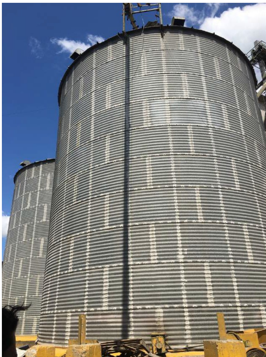
Silos donde almacenan el arroz en Procesadora Kiara.
